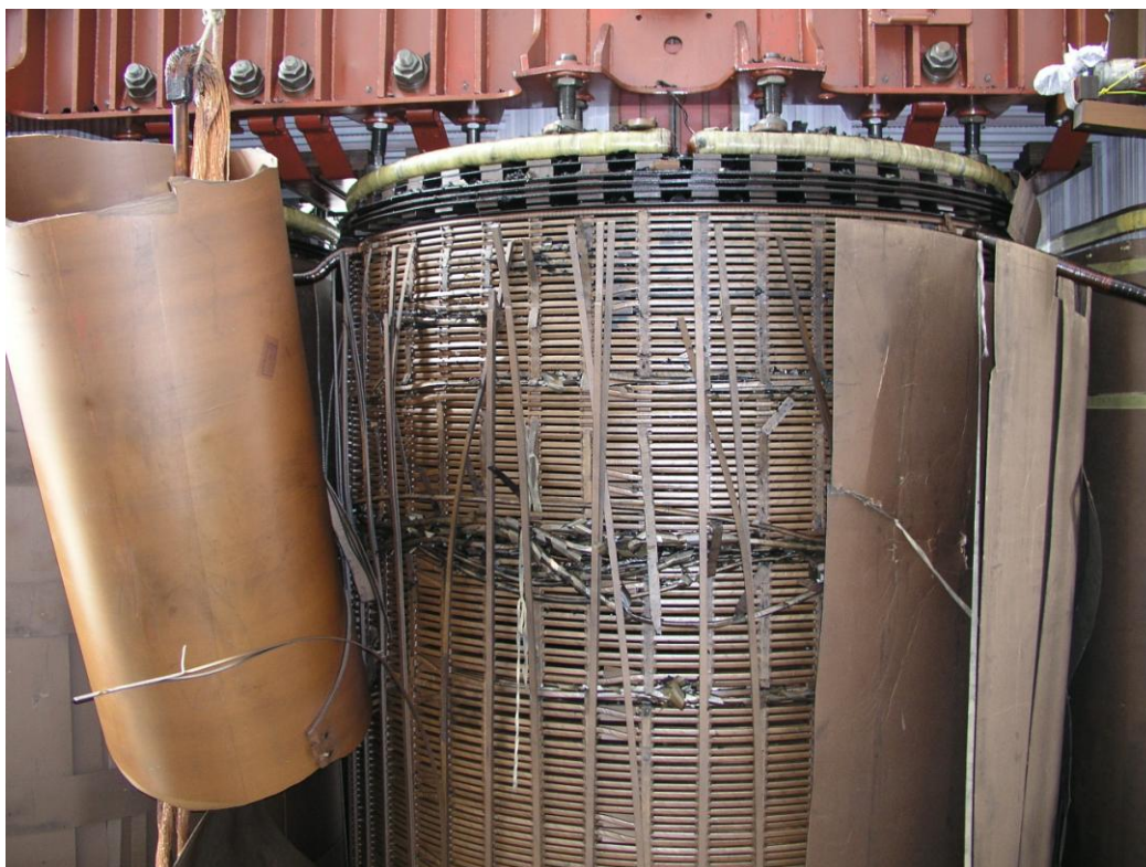
Obrázek č.4 Poškozená izolace a zkratované vinutí
