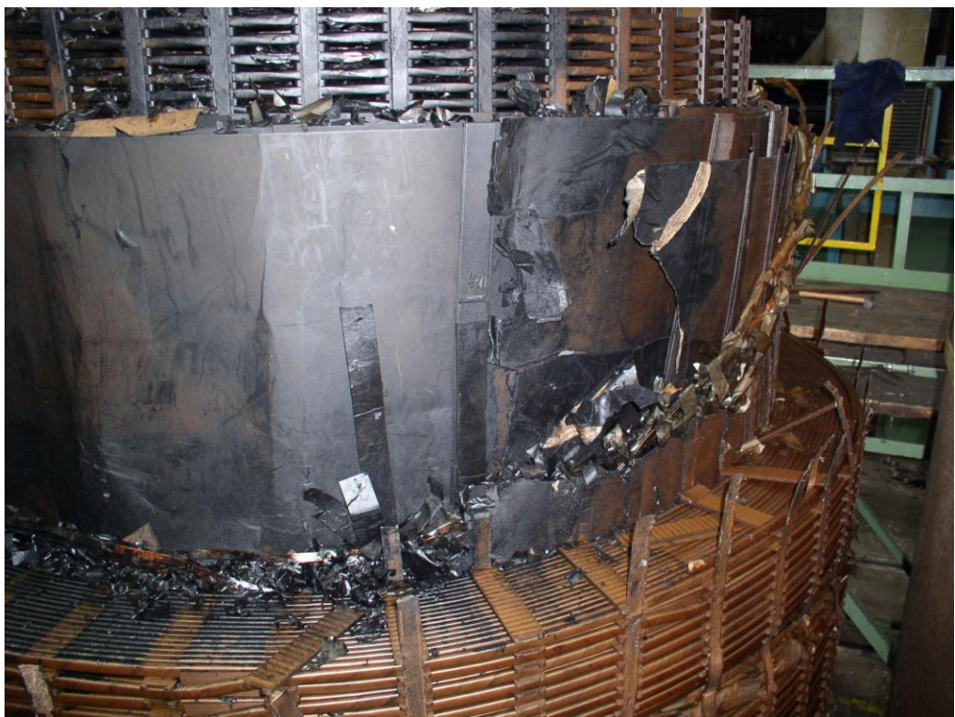
Obrázek č.8 Obnažené místo zkratu
