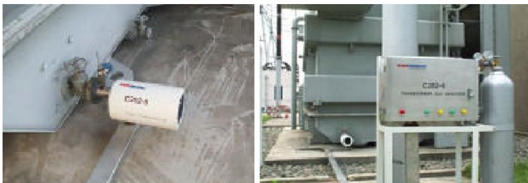
Obrázek č.10 Ukázka instalovaného senzoru a vyhodnocovací jednotky
