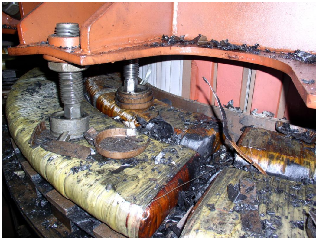
Obrázek č.5 Deformovaná konstrukce
