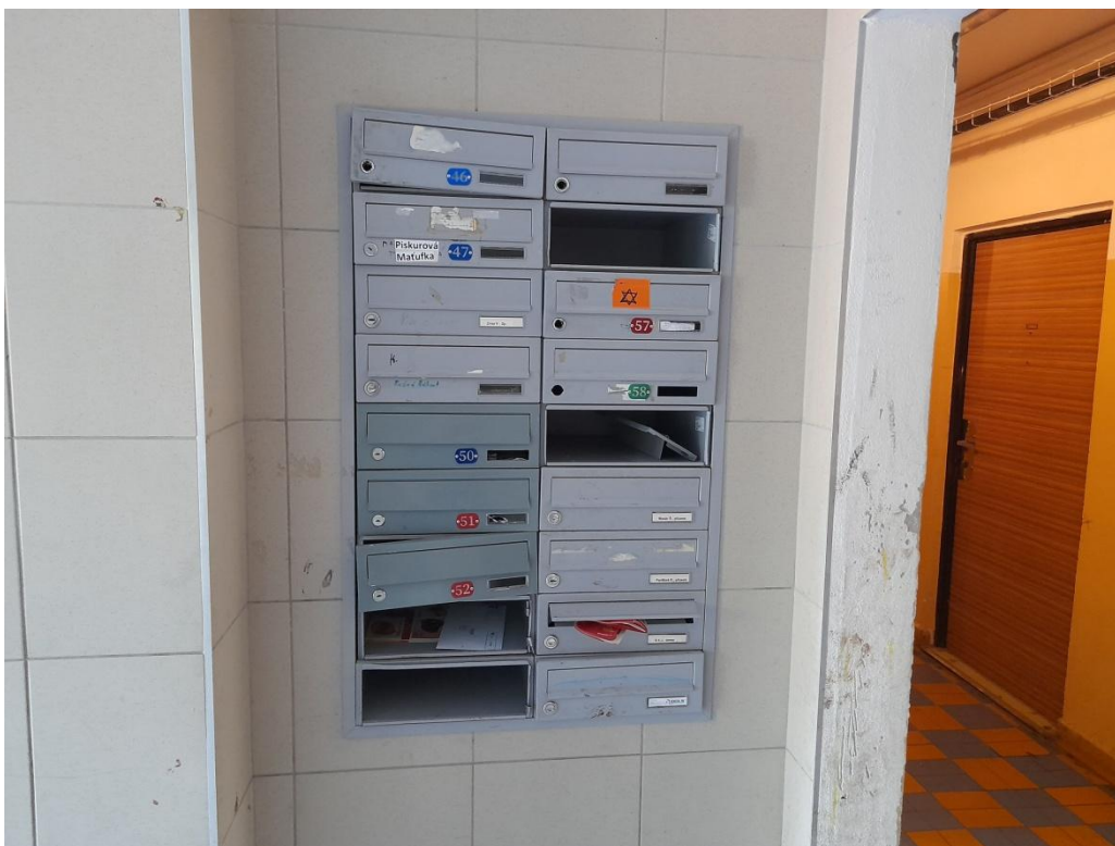
Obr. 19: Poničené schránky v panel. domě v Šumavské ul., 19. 7. 2022.
