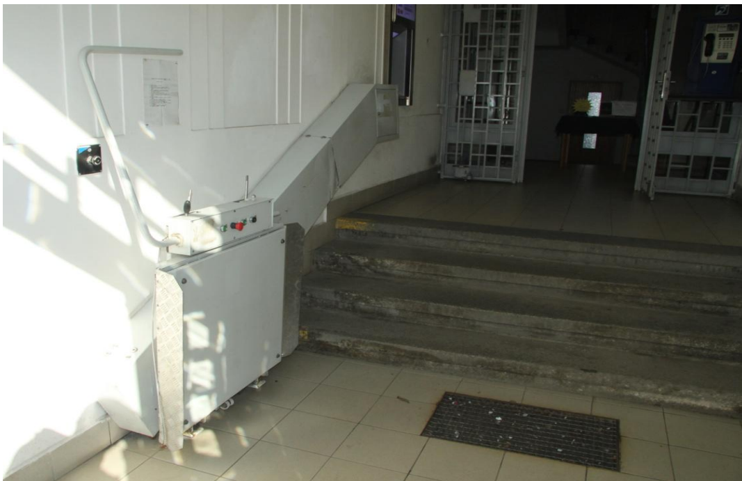
Foto 5: Zdvihací plošina v budově pošty
