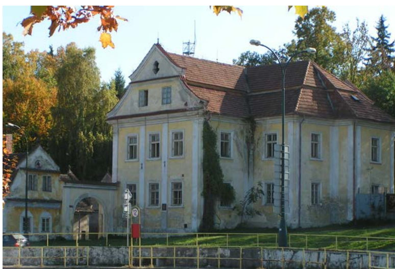
Chátrající budova nového zámku
