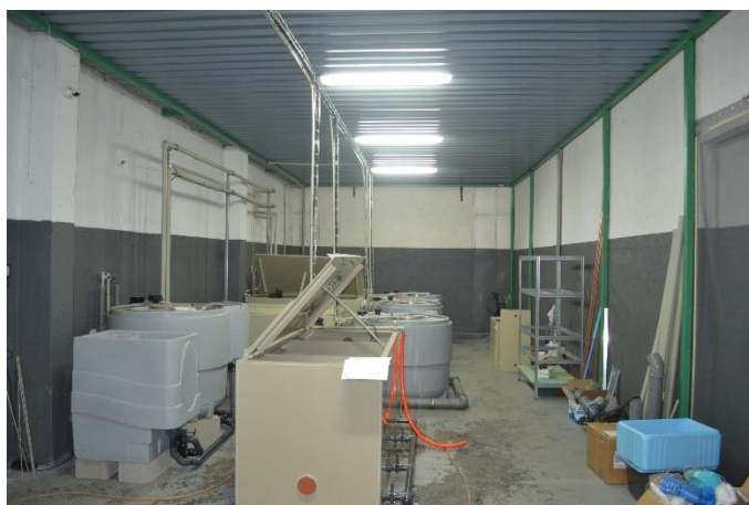
Obr. č. 15 Místnost s původní mechanickou a biologickou filtrací (vlastní foto)
