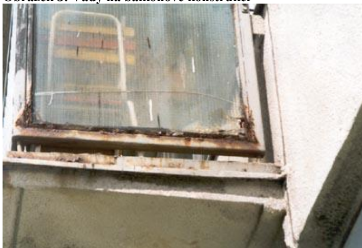
Obrázek 5: Vady na balkonové konstrukci
