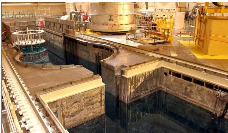
Obrázek 2 - Bazén skladování vyhořelého jaderného paliva [4]
