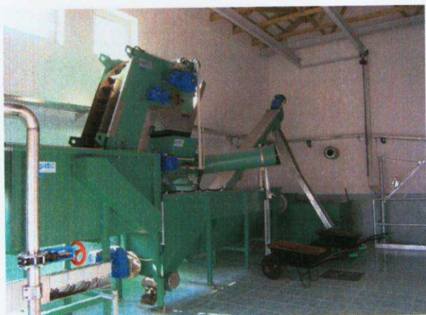
ČOV Katovice (automatické česle)
