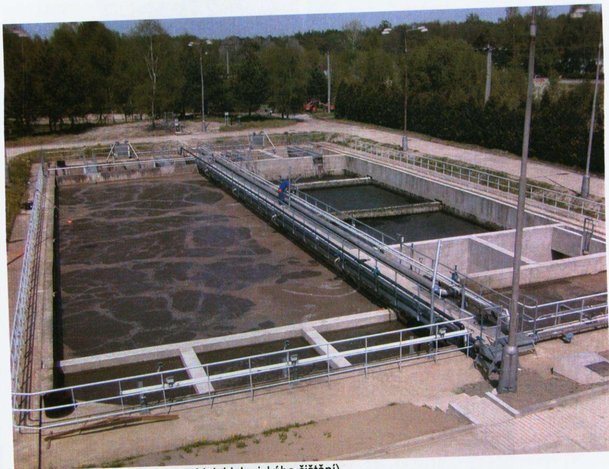
ČOV Veselí nad Lužnicí (monoblok biologického čištění)
