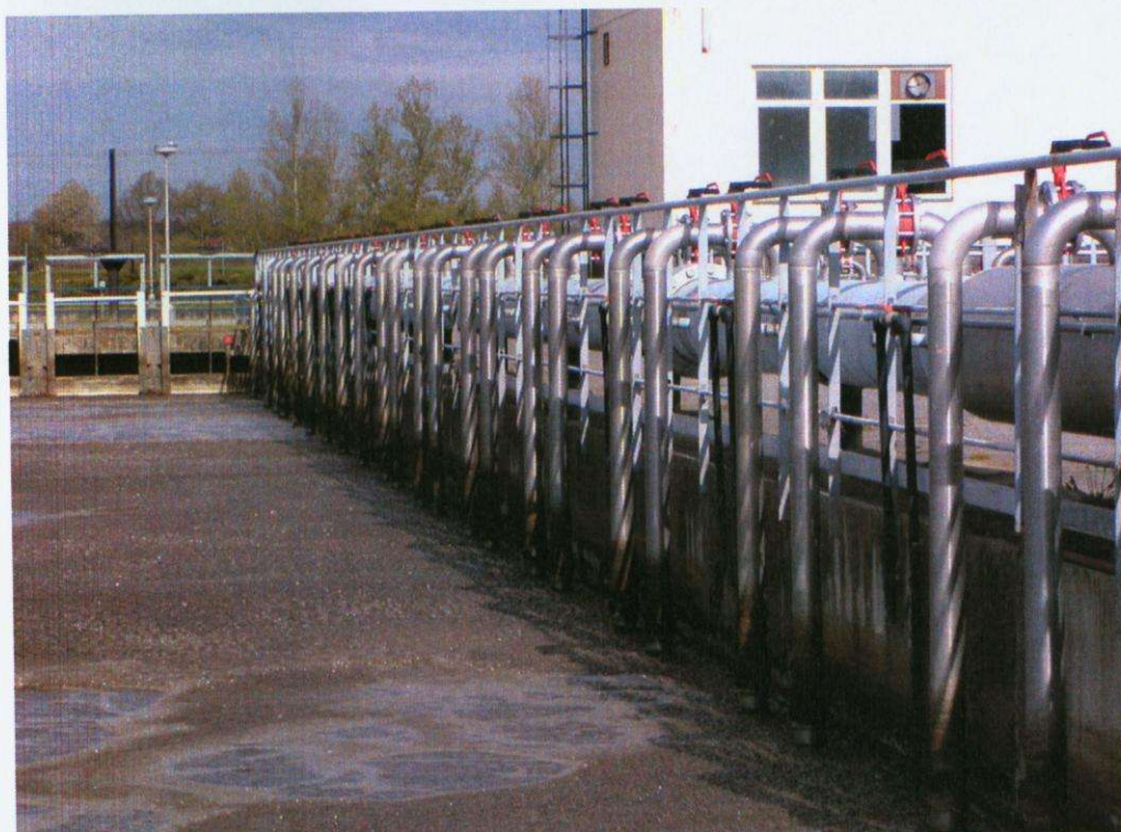
ČOV České Budějovice (potrubí pro vhánění vzduchu do aktivační nádrže)
