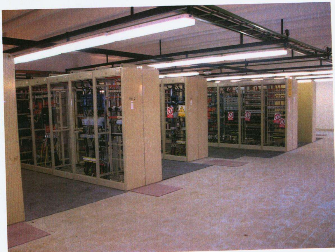
ČOV Pardubice (RM rozvaděče)
