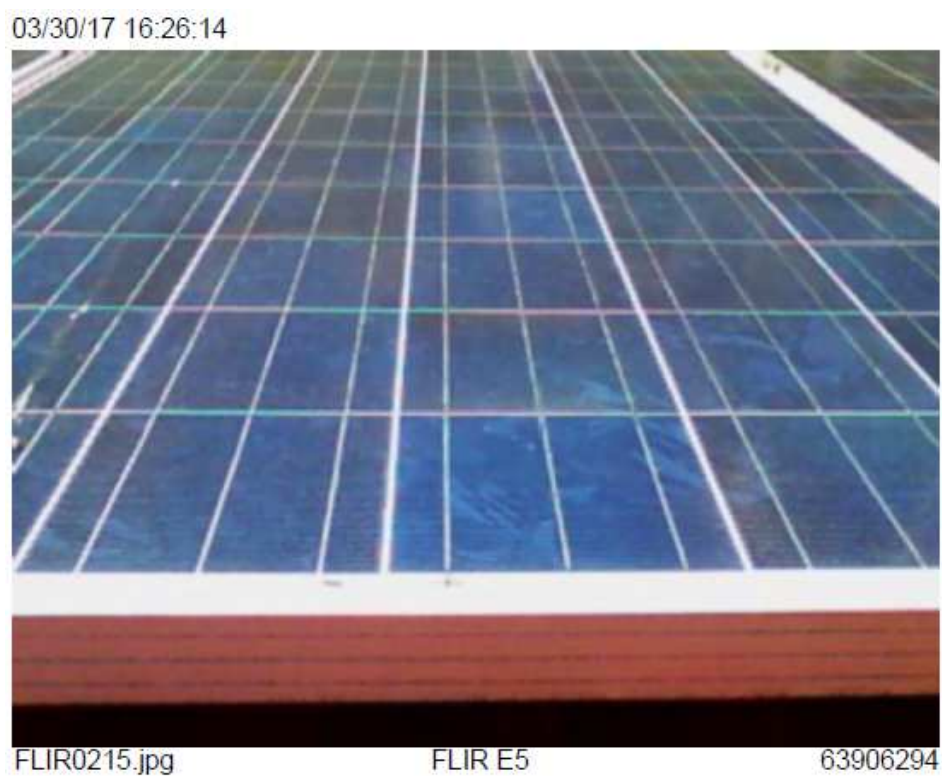
Obr. 7-9 snímek 4, západní strana, lehce korodující sběrnice
