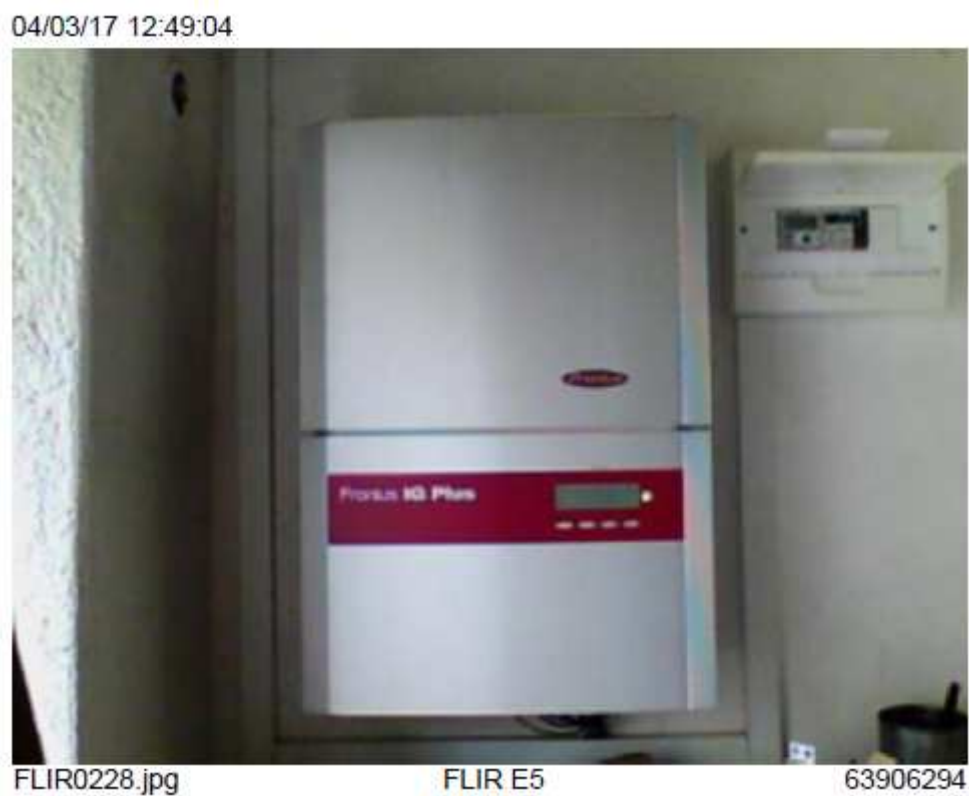
Obr. 7-18 Snímek 3, FVE 2, invertor
