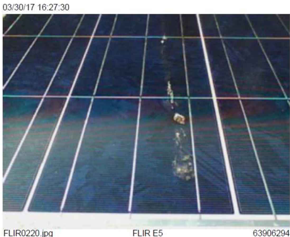
Obr. 7-6 snímek 2, západní strana, začínající degradace EVA folie
