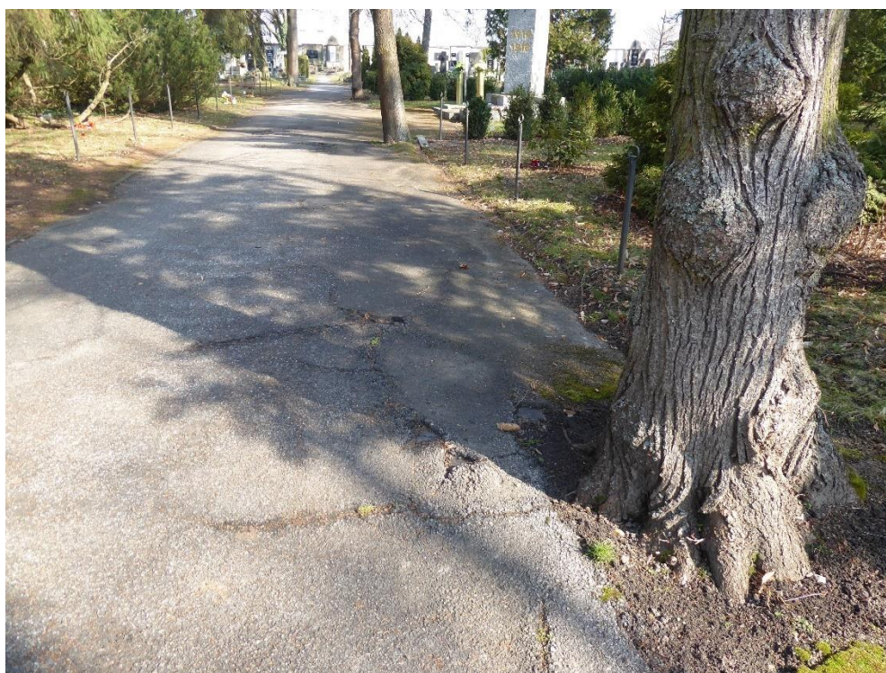
Obrázek 4.2: Narušení komunikace kořeny (zdroj: archiv PÚ)
