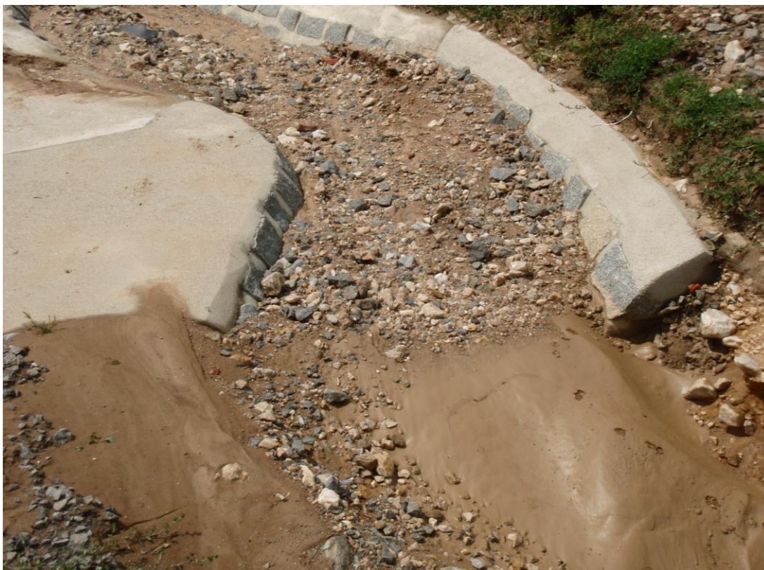
Foto č. 10.: Zanesený zpevněný příkop smytou zeminou a štěrkem
