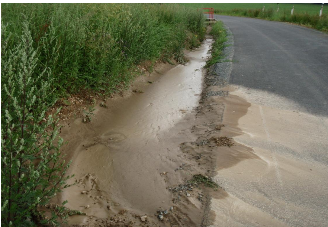
Foto č. 6.: Zanášení silničních příkopů
