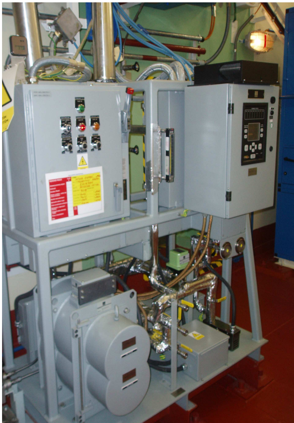
Obr.4: PIG monitor, místnost AK 1010, objekt HVB1,2
