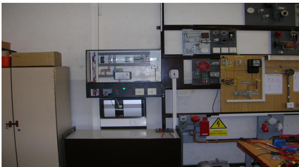
Obr. 23 Rozvaděč FV elektrárny v elektrodílně 1
