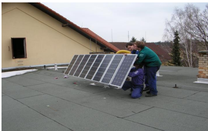
Obr. 31 FV elektrárna na střeše školy
