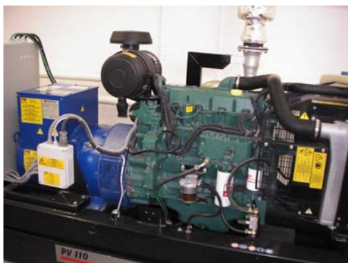
Obr.č.65 -Diesel agregát 90kW
