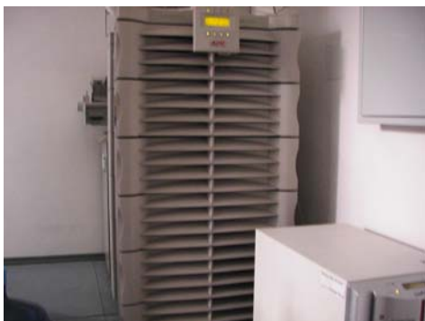
Obr.č.63 - UPS zálohující TCTV112
