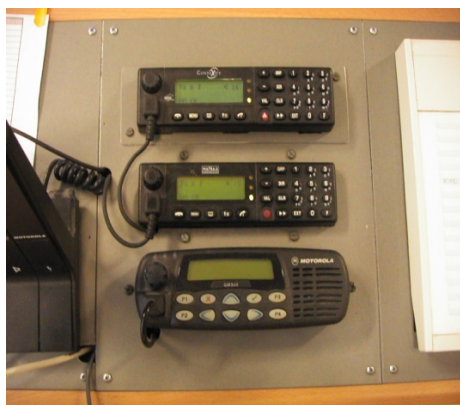
Obr.č.55 - Záložní základnové radiostanice
