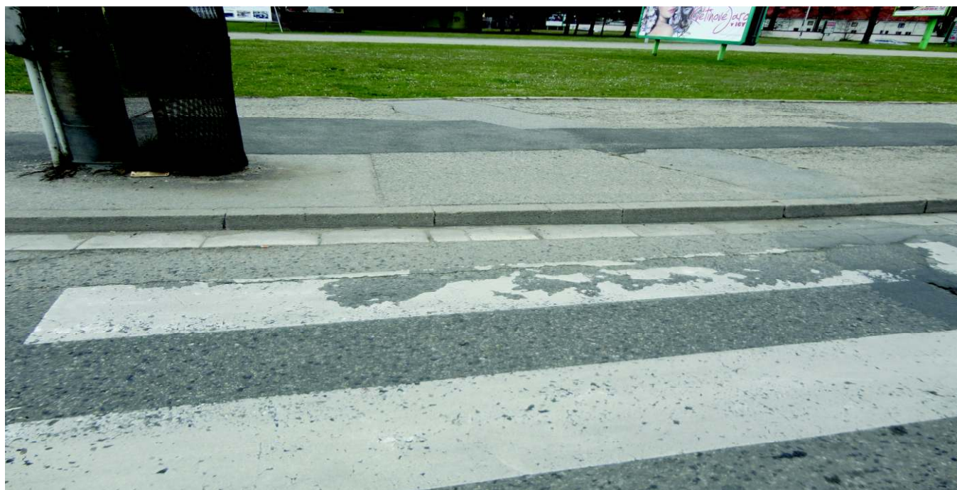
Obr. 12. U zastávky Výstaviště chybí bezbariérový sjezd na přechod pro chodce (foto-autorka)
