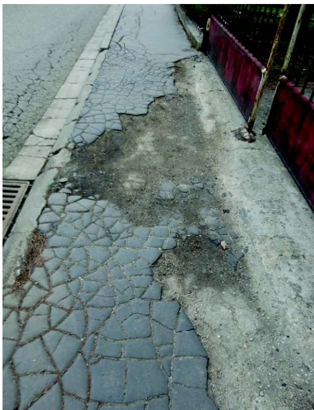
Obr. 22. Rozbitý chodník I. (trasa I.)
