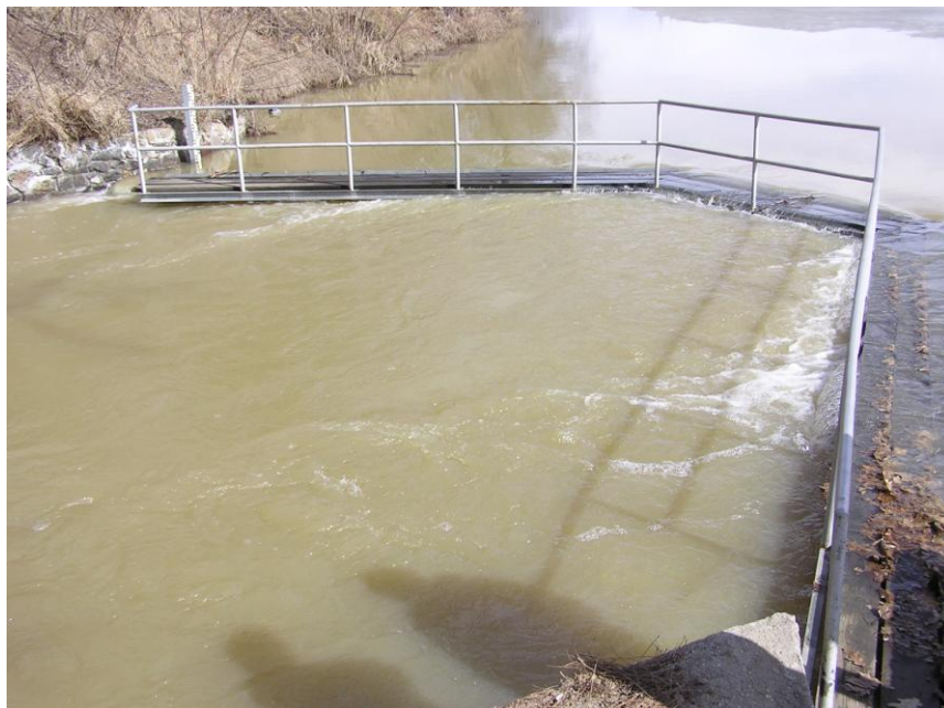
Povodeň březen 2006, bezpečnostní přeliv na nádrži Jordán
