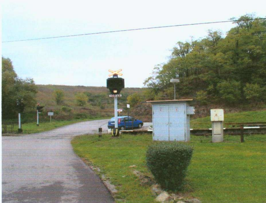
Obrázek 11. Přejezdové zabezpečovací zařízení VÚD.
