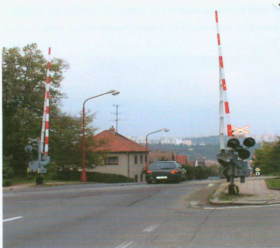
Obrázek 14. Přejezdové zabezpečovací zařízení SSSR se závorami.
