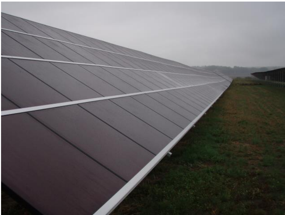
Obrázek 5: Fotovoltaická elektrárna v Čejči (Ing. Malivánek, 2009)
