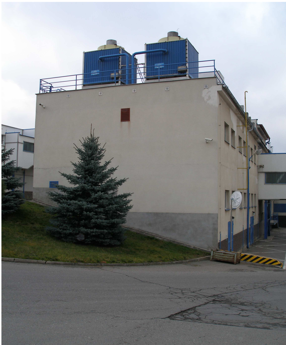
Obr.č. 5 - Budova strojovny, s 2 kusy odpařovacích kondenzátorů na střeše
