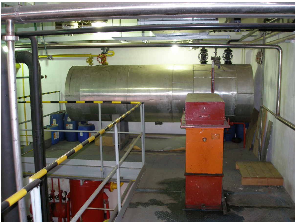
Obr.č.2 - Vysokotlaký sběrač amoniaku 2 000 litrů
