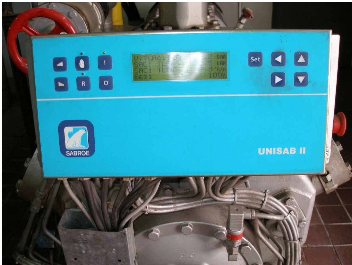
Obr.č. 4 - Řídící jednotka UNISAB kompresoru SABROE – pro automatický provoz
