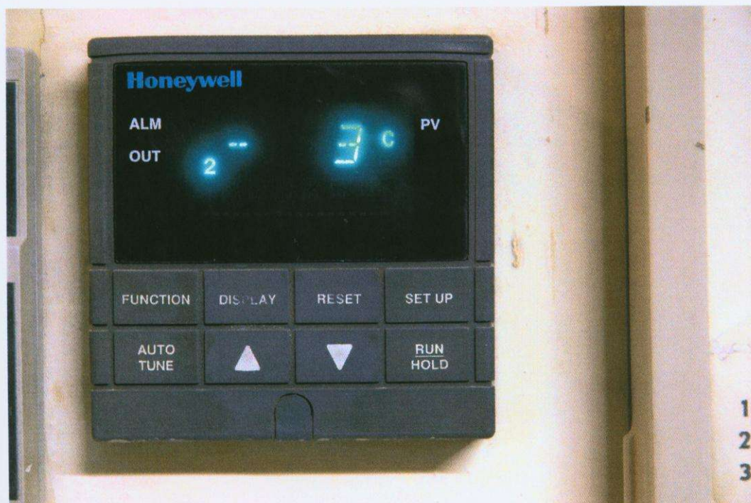
Fotografie č. 7 - Původní regulátor Honeywell
