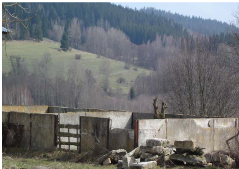
Obr. č. 13 : Zastaralé nádrže pro uskladnění hnojiva
