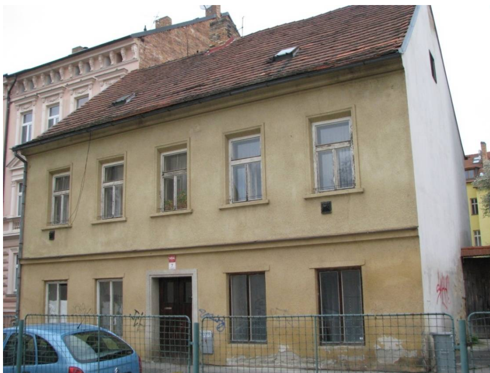
Foto 4: Málo udržovaná budova v ulici B. Smetany (plocha č. 3)
