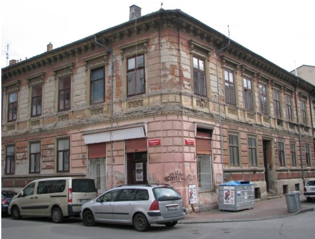
Foto 5: Oprýskaná stará zástavba na rohu ulice Otakarova a Riegrova (plocha č. 4)
