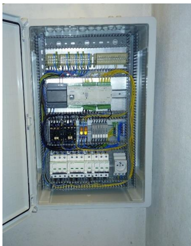
Obr. 18. - Připravený rozvaděč pro připojení periférií (foto autor)
