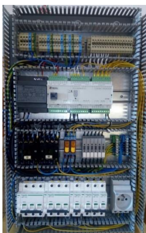
Obr. 16. - Rozložení komponent v rozvaděči (foto autor)
