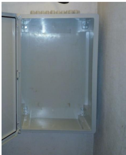
Obr. 17. - Rozvaděč na pozici (foto autor)
